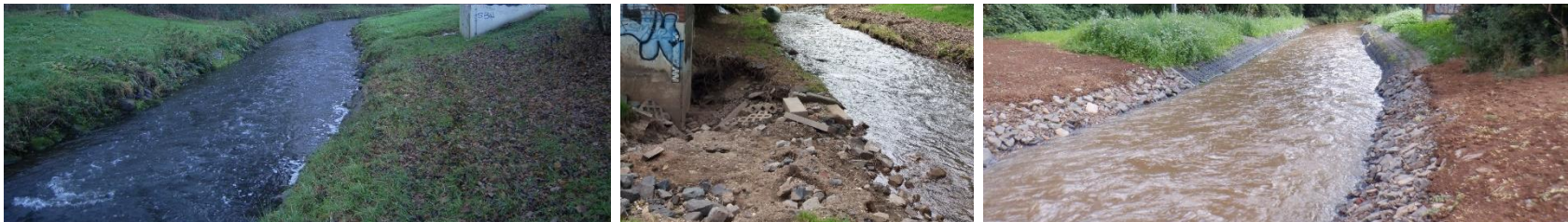
Abb.: Pegel Horschheim vor dem HW 21, kurz danach und nach dem Wiederaufbau (Quelle: Erftverband).
