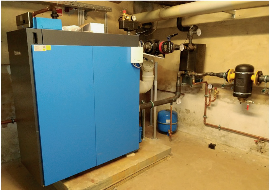
Neue Heizungsanlage im Rathaus. Foto: Stadt Rheinbach
